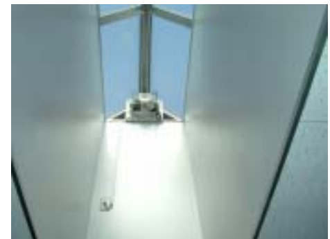
常時換気装置
