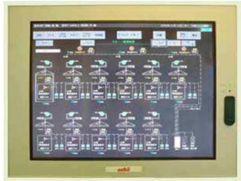
ガス集中管理システム
