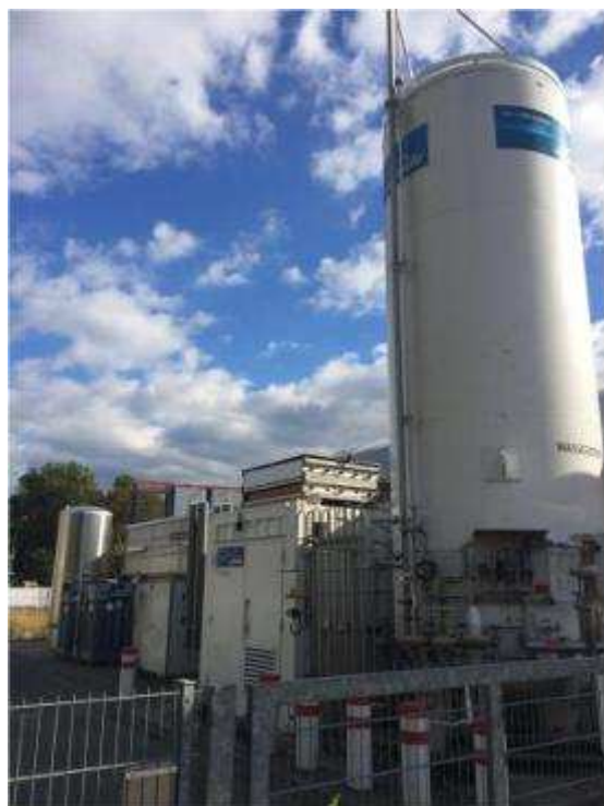
液化水素設備
