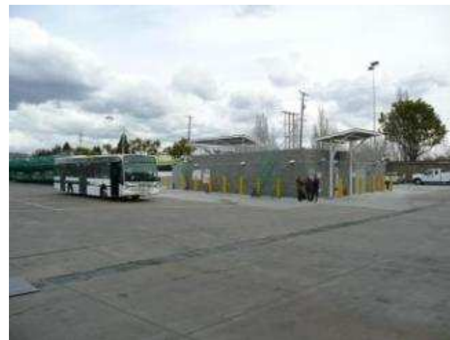
35MPaバス充填用機器全体 (液水貯蔵タンク、35MPa用圧縮機、蓄圧器)
